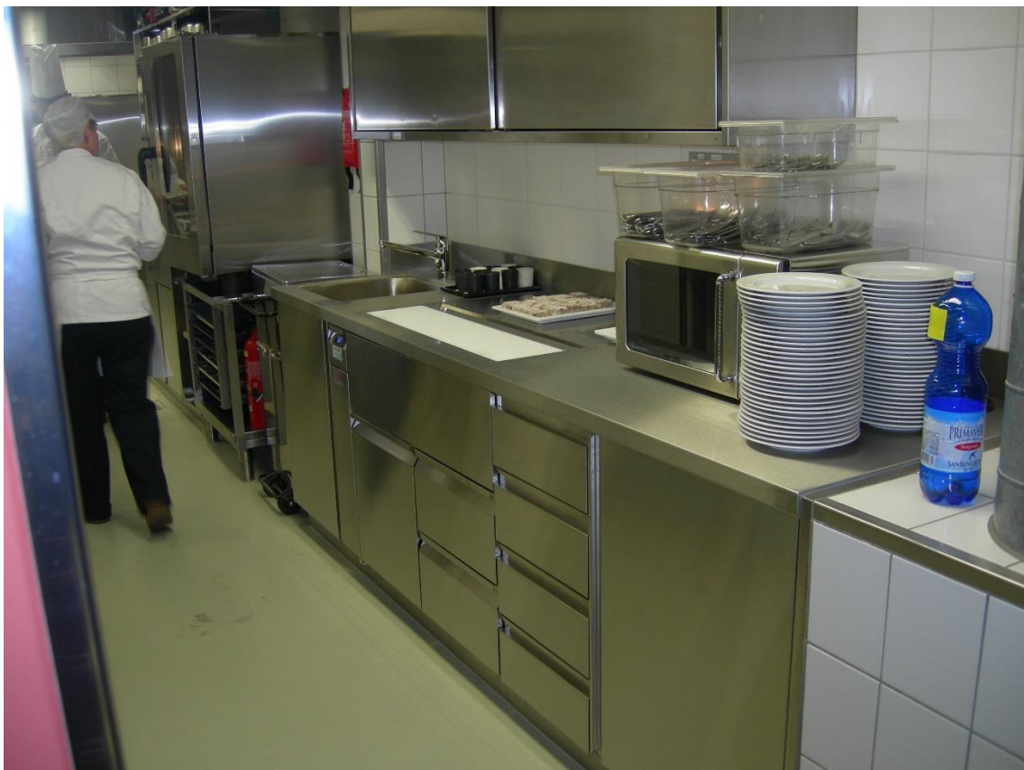
Vorgelagert und zum Büffet hin ausgerichtet befindet sich der Arbeitsposten für die kalte Küche.
