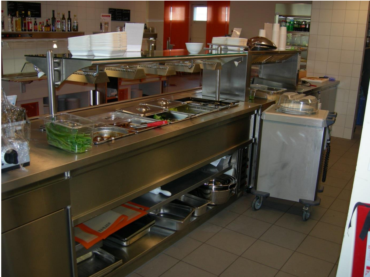
Die beheizte Schöpfstation ist mit Licht und Wärmestrahlern ausgerüstet.
